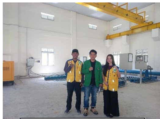
Peralatan Kontrol Rumah Katup
