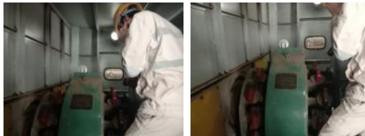
Gambar 1. Pengukuran suhu pada brush eksitasi generator
