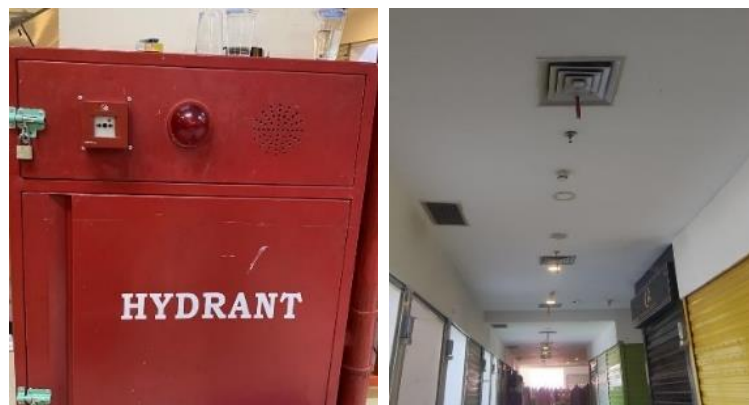
Gambar 5.14 Kondisi aktual alarm dan detektor pada gedung Pasar Sentral ( New Makassar Mall )
