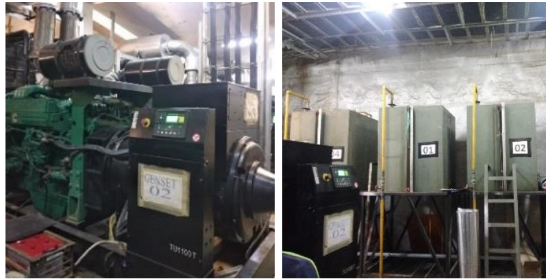
Gambar 5.25 Kondisi aktual listrik darurat pada bangunan gedung Pasar Sentral ( New Makassar Mall )
