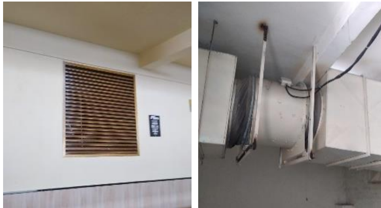
Gambar 5.20 Kondisi aktual pressurized fan di lantai tujuh pada bangunan gedung Pasar Sentral ( New Makassar Mall )
