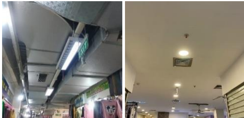
Gambar 5.13 Kondisi aktual langit-langit lantai dasar dan lantai dua pada Pasar Sentral ( New Makassar Mall )
