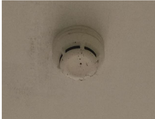
Gambar 5.21 Kondisi deteksi asap pada bangunan gedung Pasar Sentral ( New Makassar Mall )
