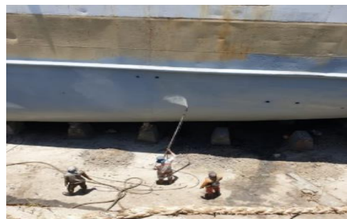
Pekerja Tidak Menggunakan APD
