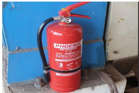
Penempatan APAR tidak digantung dan tersembunyi
