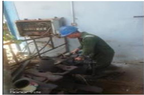
Pekerja Tidak Menggunakan Earplug
