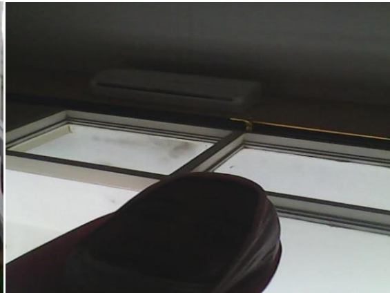
Dokumentasi 4 : AC yang tidak berfungsi pada salah satu ruangan perawatan yang dapat mengganggu kenyamanan Pasien
