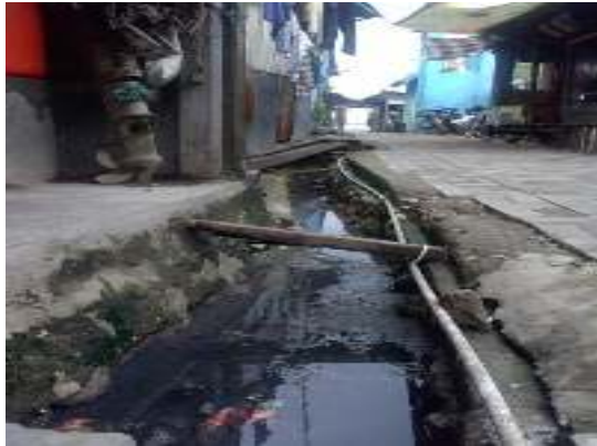
Gambar 36 : Kondisi Drainase Sumber : Survey Maret 2015
